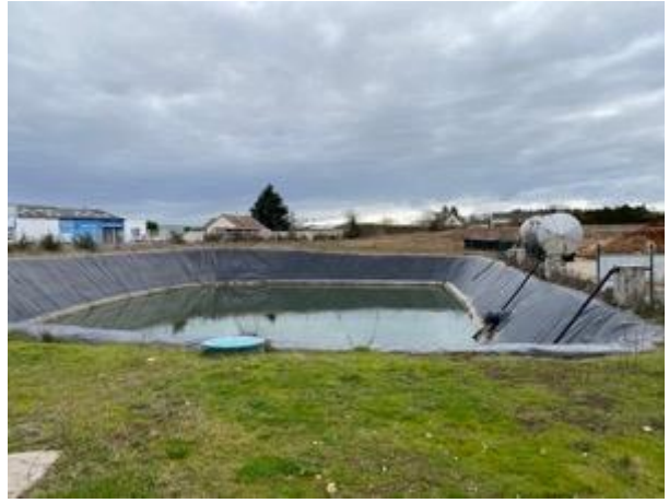
Bassin (accès au système de régulation au 1 er plan)
